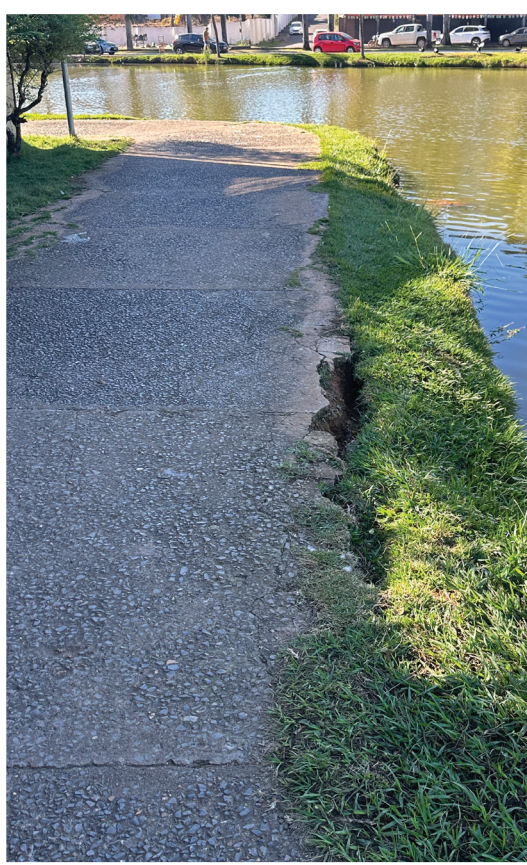
Buracos abertos geram riscos
