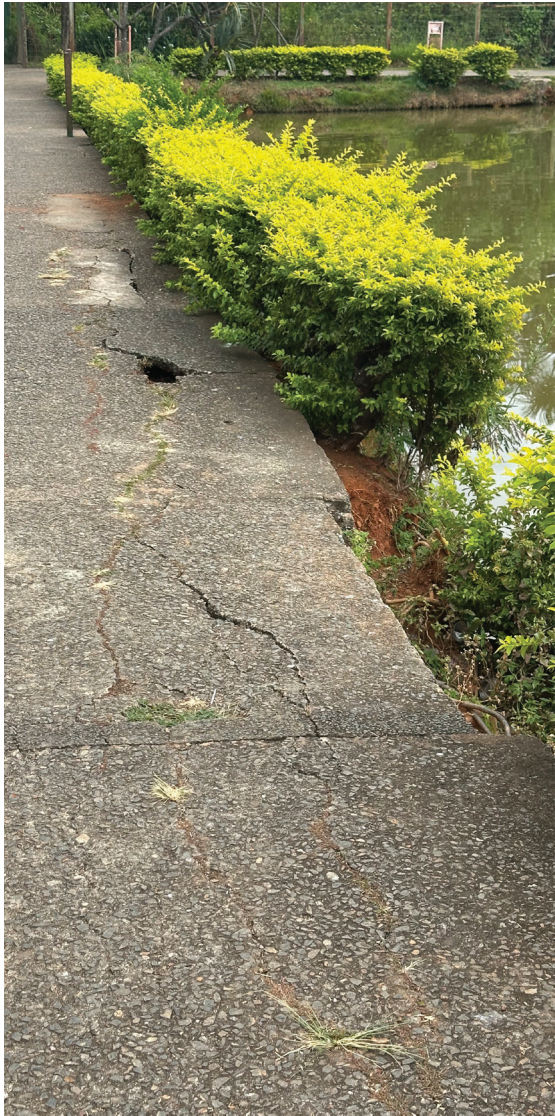
Risco de desmoronamento da calçada
