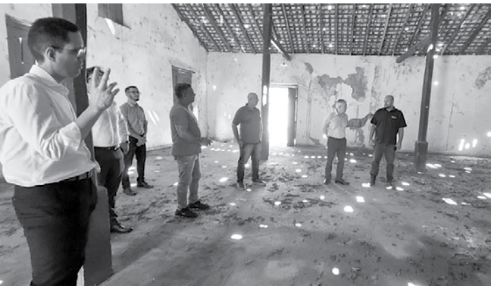
Interior da igreja. Péssimas condições
