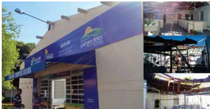
Risco de tragédia anunciada com o desabamento
